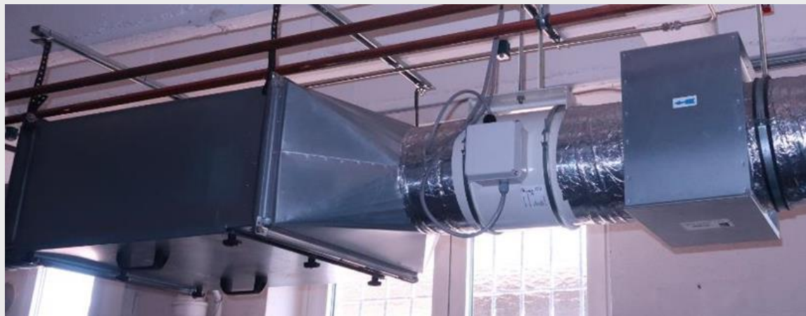
图 12：排气系统的空气精细过滤器、管风扇和空气预过滤器
